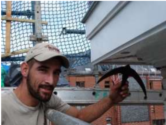
Gaten in oude kroonlijsten bij de renovatie van daken.
